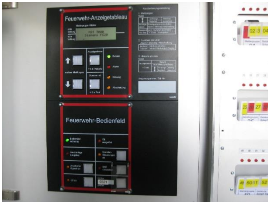
Bild 19 Im linken Teil der Erstinformationsstelle befindet sich das Feuerwehranzeigetableau (FAT) und das Feuerwehrbedienfeld (FBF).
