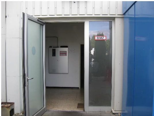
Bild 9 Das Hinweisschild mit der Aufschrift „BMZ“ kennzeichnete einstweilen den Feuerwehrehauptzugang zur Erstinformationsstelle, bei bestehenden Brandmeldeanlagen.
