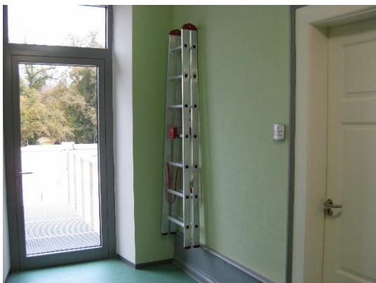
Bild 29 Ordnungsgemäß angebrachte Leiter gemäß Planung BMA in unmittelbarer Nähe der Zugangstür. Die Erkundungsleiter dient der Feuerwehr zum Auffinden von Brandmeldern in Zwischendecken.
