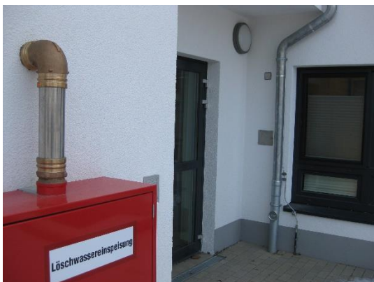
Bild 11 Das Freischaltelement (FSE) ist in einer Höhe von maximal 2 m eingebaut.
