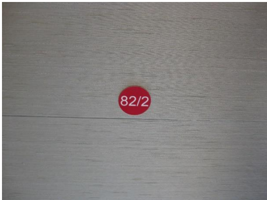
Bild 27 Roter Punkt zur Kennzeichnung von Deckenplatten oder Revi-Klappen, hinter denen Brandmelder in Zwischendecken verbaut sind. Auf dem roten Punkt sind gleich die Nummern der Meldergruppe und des Brandmelders eingraviert.
