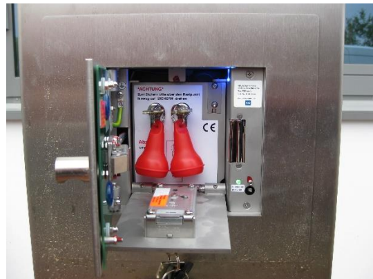
Bild 6 Das Feuerwehrslüsseldepot ist mit zwei Profilhalbzylindern und zwei gleichen Gebäudeschlüsseln ausgestattet. Die Innentür ist zur Aufnahme eines Umstellschlusses vorbereitet.
