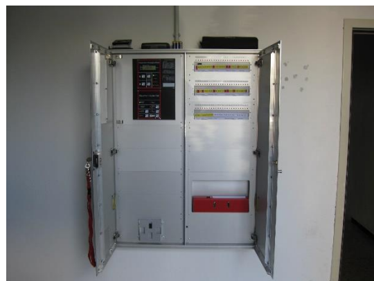
Bild 18 Erstinformationsstelle im geöffneten Zustand. Für den Feuerwehrplan ist ein Einstellfach auf der rechten Seite eingebaut worden. Feuerwehrplan und Feuerwehrlaufkarten müssen durch den Betreiber der Brandmeldeanlage eigenverantwortlich aktualisiert werden, sofern dies notwendig ist.
