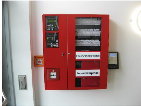
Bild 14 Erstinformationsstelle mit transparenter Tür auf der rechten Seite und Handfeuermelder auf der linken Seite.
