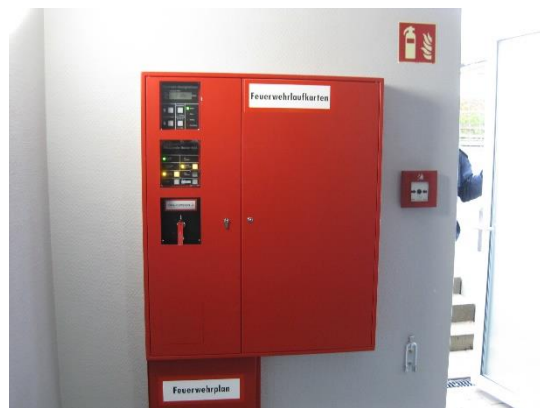
Bild 22 Der Feuerwehrplan wird, aufgrund Platzmangel in der Erstinformationsstelle, in einem separaten Blechkasten hinterlegt. Sowohl die Feuerwehr als auch der Betreiber muss Zugriff auf den Feuerwehrplan haben.
