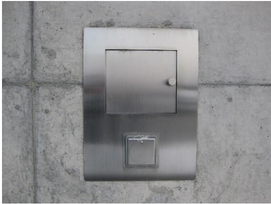
Bild 1 Feuerwehrslüsseldepot (oben) mit Freischaltelement (unten) standardgemäß in einer Wand eingebaut.
