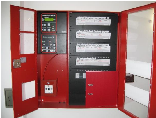
Bild 15 Erstinformationsstelle im geöffneten Zustand. Der Feuerwehrplan (roter Ordner) ist auf der rechten Seite einfach nur eingestellt. Die Feuerwehrlaufkarten sind gut sichtbar angeordnet.
