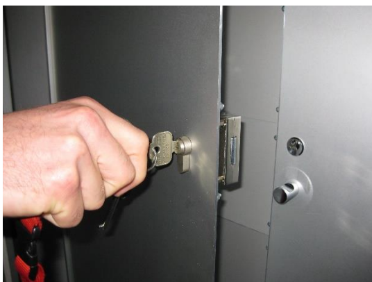
Bild 17 Die linke Tür der Erstinformationsstelle ist mit der Feuerweherschließung (PZ) gesichert. Die rechte Tür ist mit einem einfachen Schloss (CL1-Schloss) gesichert und kann durch den Betreiber der BMA geöffnet werden.
